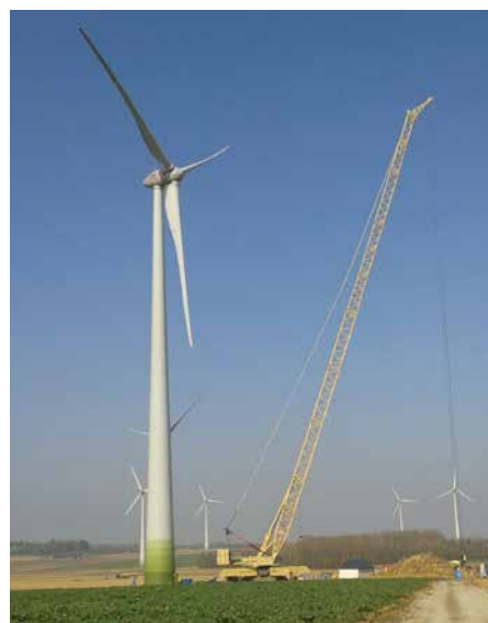
In 2017 werden drie nieuwe windmolens gebouwd in Floreffe.
