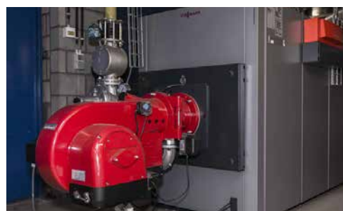
Nieuwe condensatieketel van de laatste generatie
